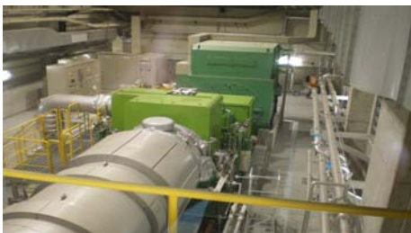
蒸気タービン発電機
