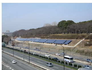
太陽光発電設備
