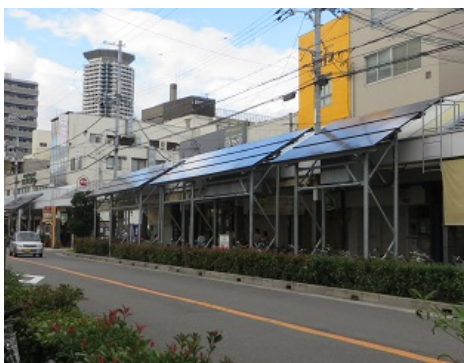
旭通商店街の太陽光パネル
