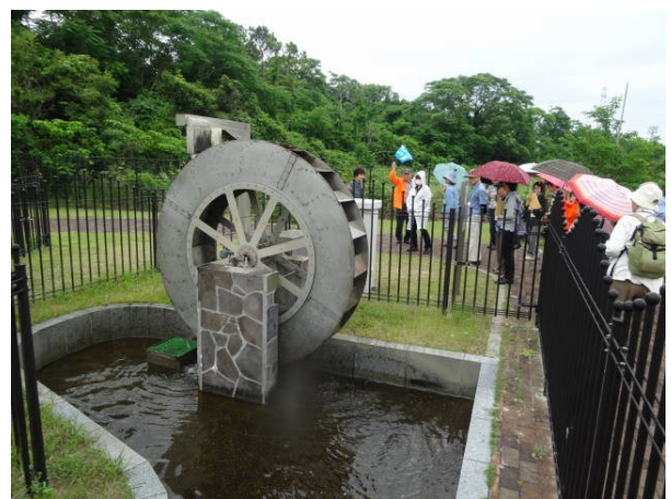
マイクロ水力発電設備
