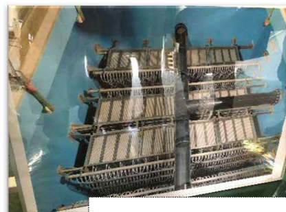
膜浸漬槽で膜ろ過を行う
